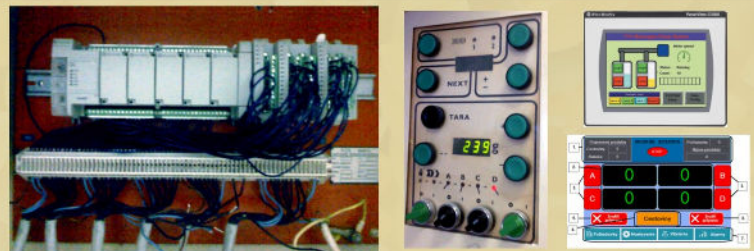
Obr. 3. – Nové PLC a ukážka starého riadiaceho panelu a novo-vytvorenej vizualizácie
